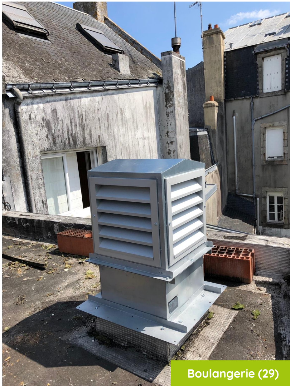
Grille acoustique sortie de toiture
